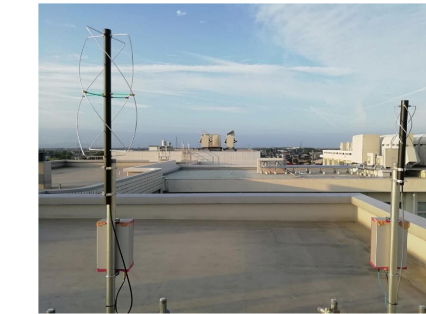
アンテナの設置例
