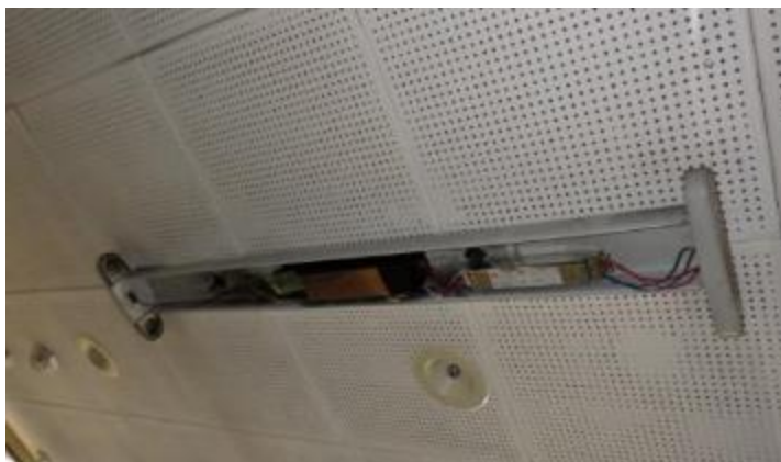
LED化照明器具内部（本体は未交換）
