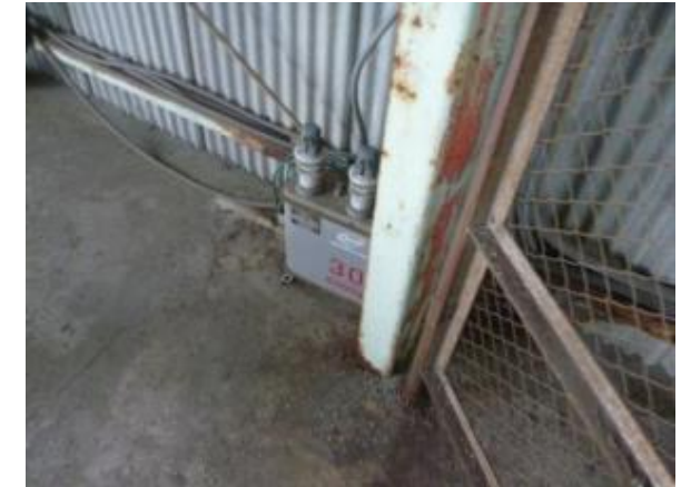
廃工場の電気室に残置されていた例
