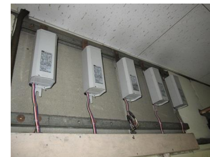
工場等の壁際に設置されている例
