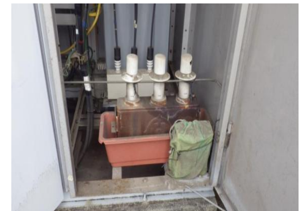
キュービクル内に保管されていた例
